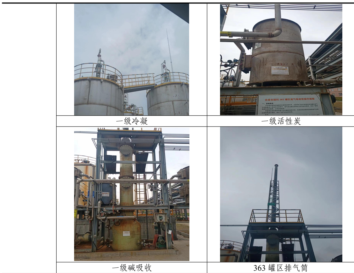
图 4.1.2-2 废气治理设施图片
