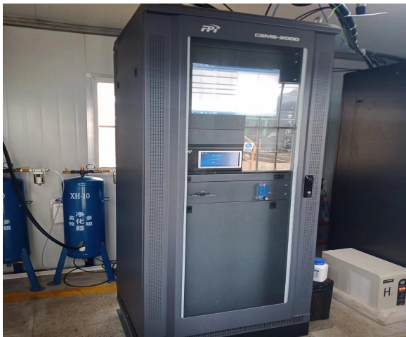
5#RTO 焚烧炉系统在线 CEMS
