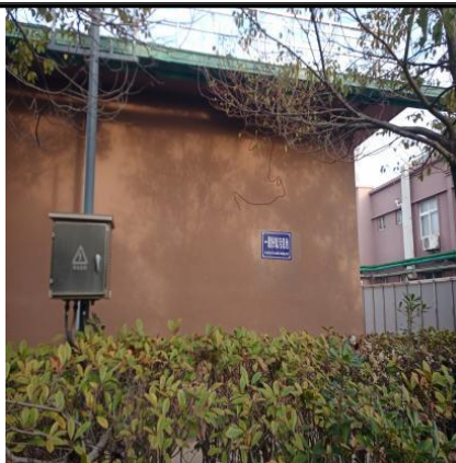
三期生化-一段好氧污泥池
