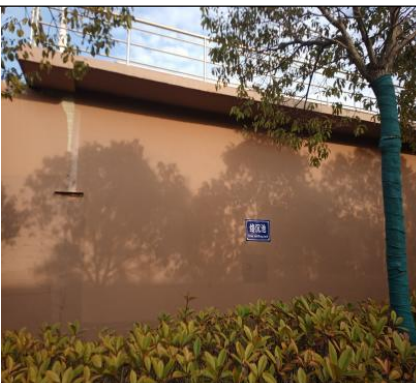
三期生化-终沉池
