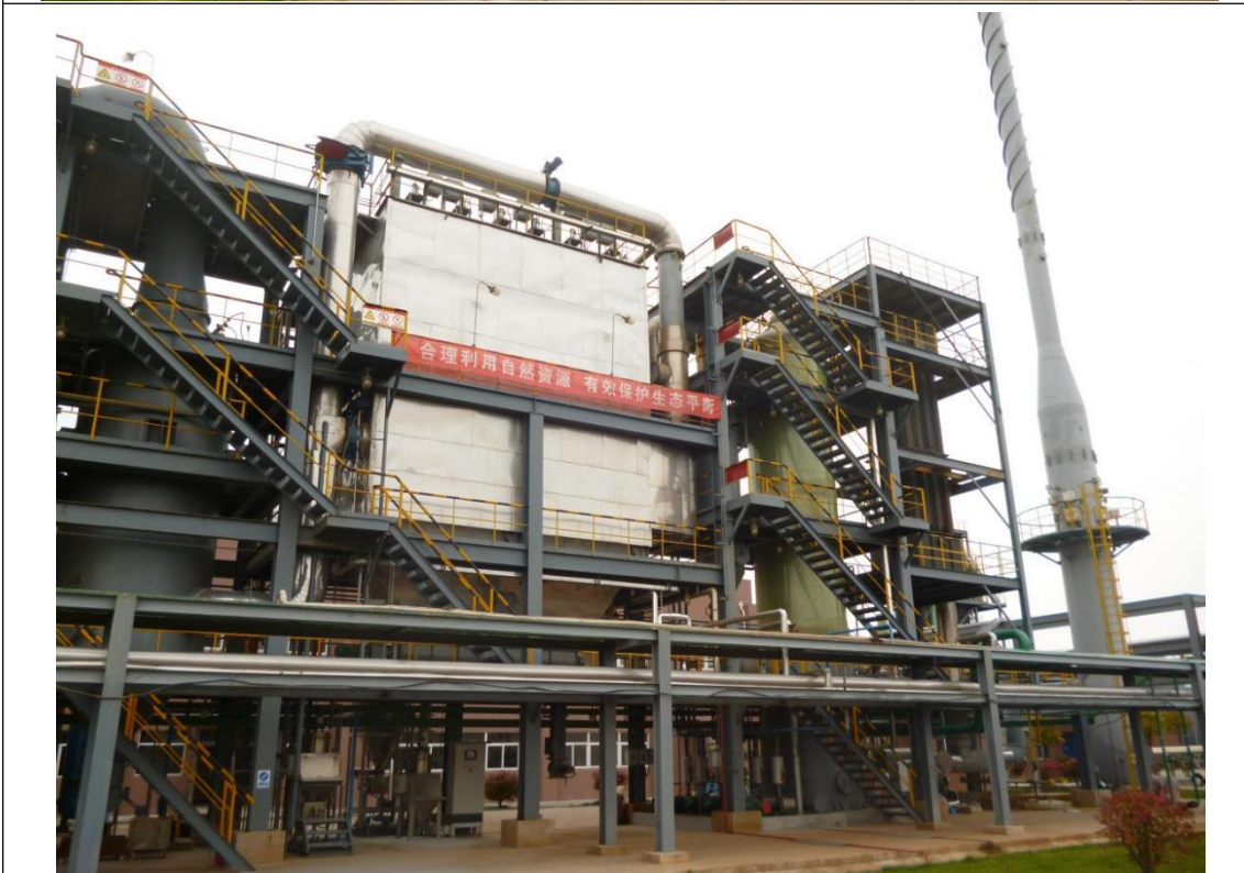
固废焚烧炉照片
